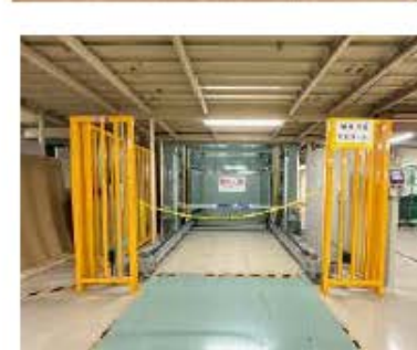
垂直搬送機×1基 1基（1階～8階本床各フロア停止）
